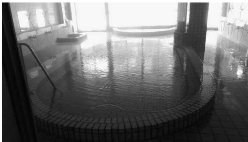
参考資料③：公衆浴場「くすのき」の浴場。施設の裏にボイラーがあるため、冬季は若干の加温があると思われる。
